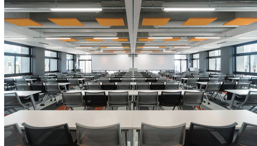
3つある教室は、仕切り方によってサイズが可変となる。空調はソックダクト方式により、風が直接当たる不快感をなくし、部屋全体の温度を均一にする。
