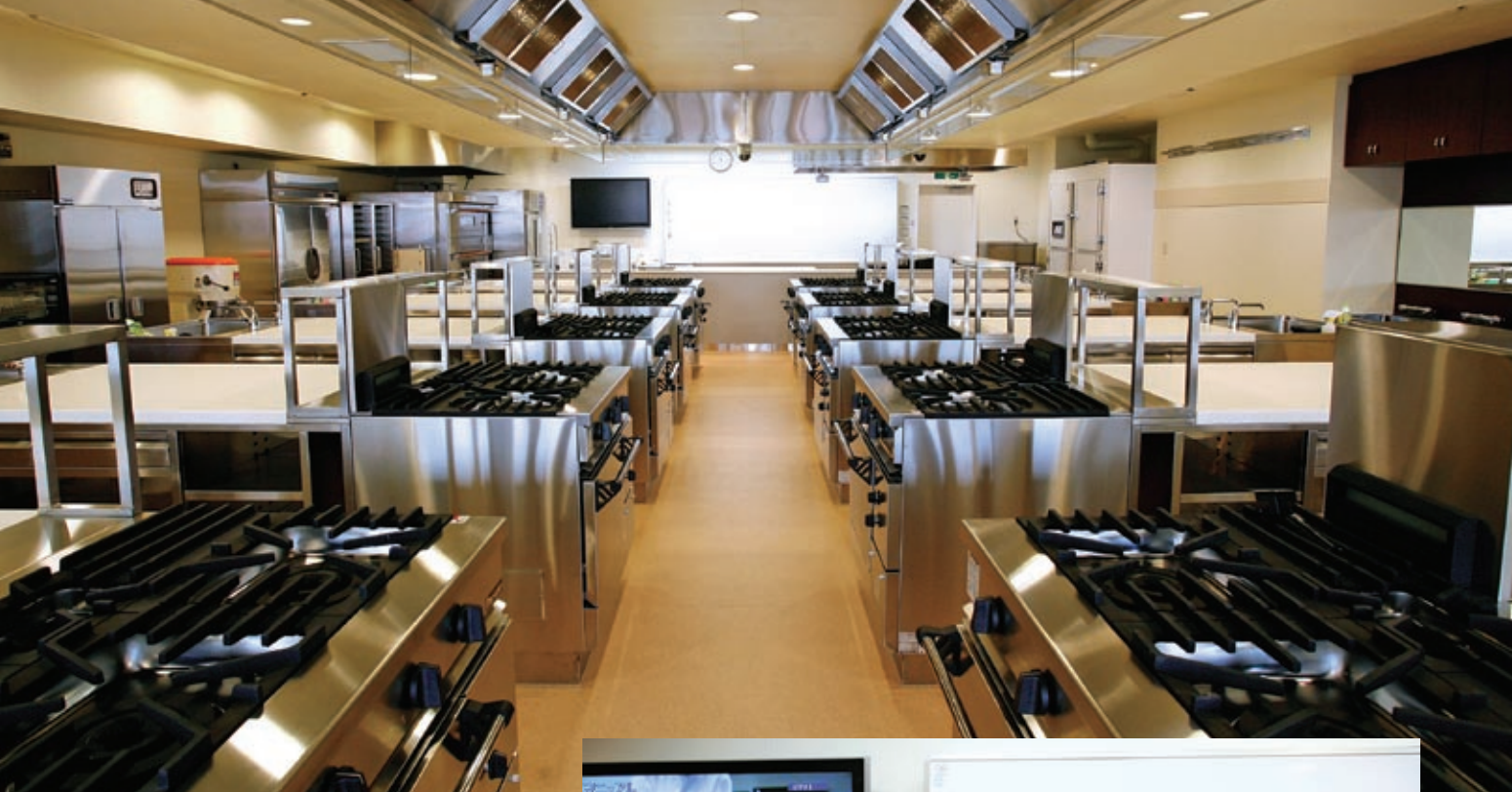
1クラス40人の調理実習室には10台の調理台を設置。4人で1台を使用でき、1人1枚ずつまな板を置ける余裕のスペース。
