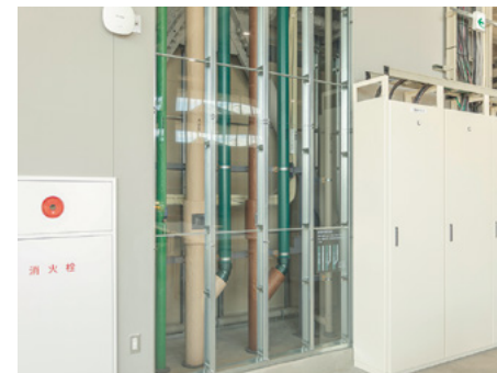
排水等の配管の「見える化」
